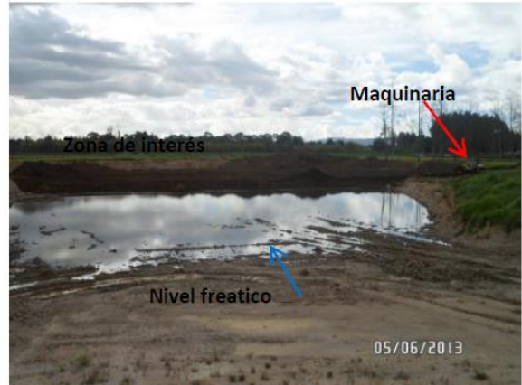
Fotografía No. 16. Niveles freáticos altos en el área de interés
