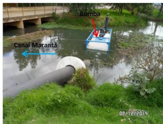
Fotografía No. 20. Estación de bombeo canal Marantá
